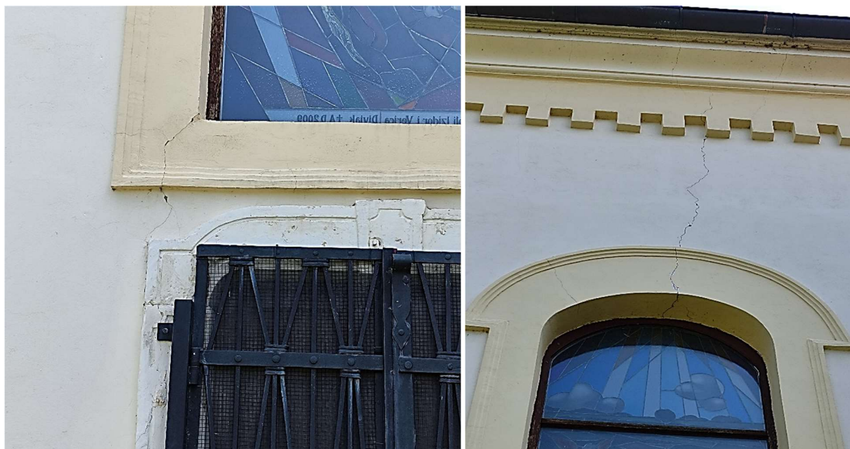
Oštećenje SI2 – pukotine u tjemenu i parapetu prozora na sjeveroistoku
