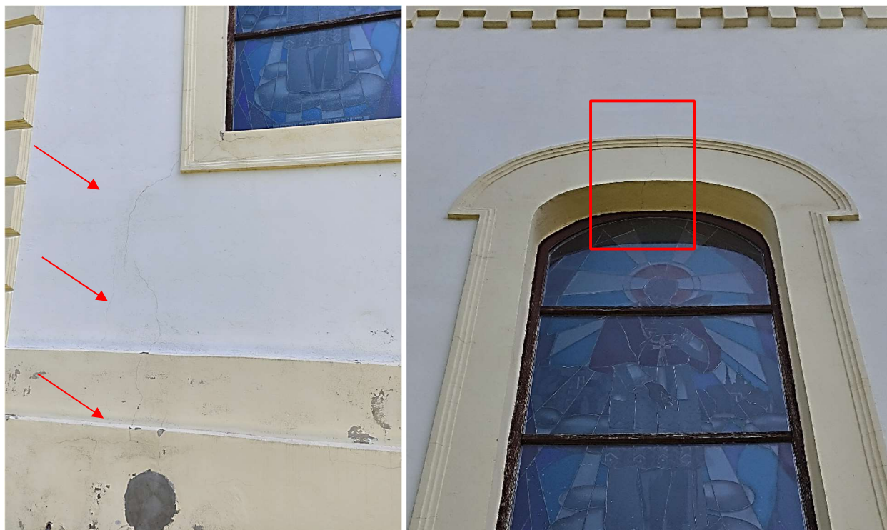
Oštećenje SI1 – pukotine u tjemenu i parapetu prozora na sjeveroistoku
