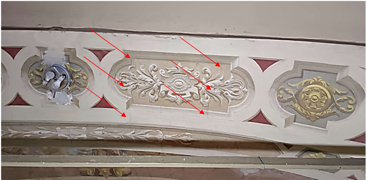
Oštećenje 3 – pukotine na pojasnom luku koji se nalazi između pjevališta i lađe
