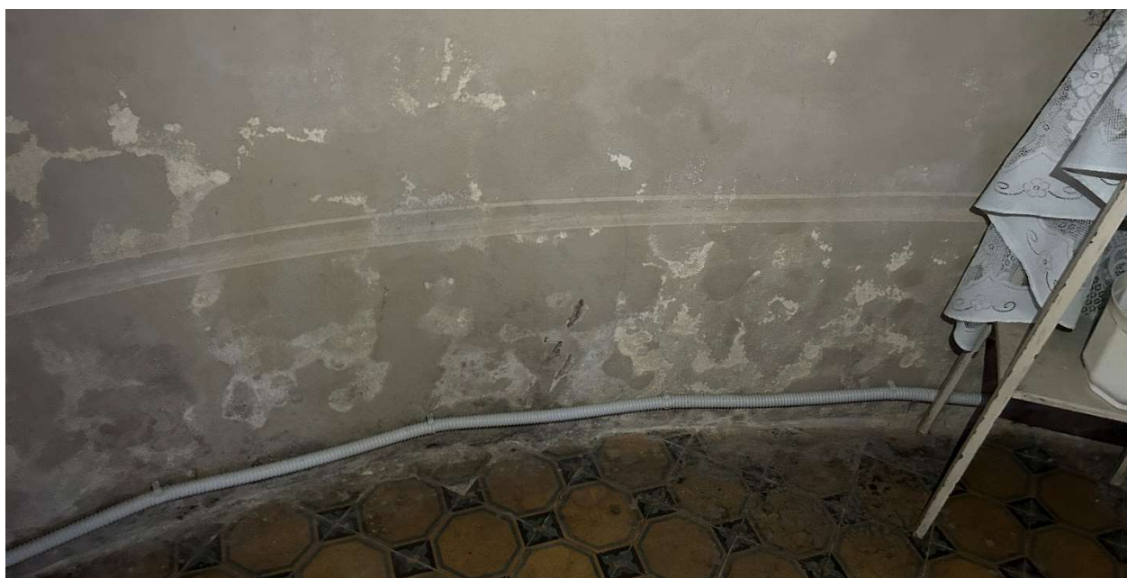
Oštećenje 10 – vlaga na donjem dijelu sjeverozapadnog zida svetišta
