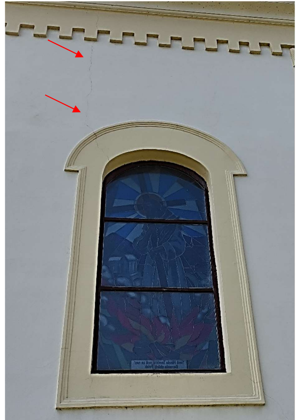
Oštećenje JZ2 – pukotine u tjemenu prozora na jugozapadu
