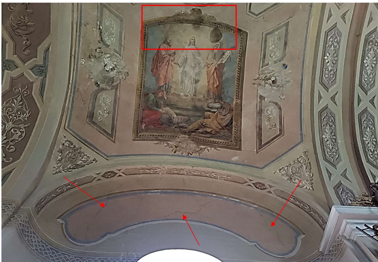
Oštećenje 6 – sitnije pukotine po zidu iznad jugozapadnog prozora i vlaga na svodu
