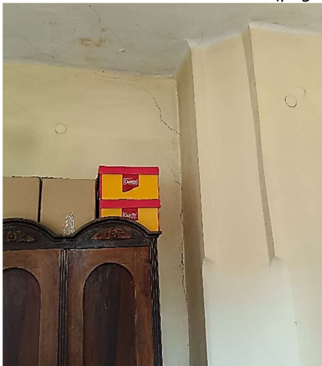
Oštećenje 12 – vertikalna pukotina na spoju dva zida sakristije
