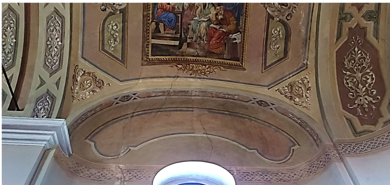
Oštećenje 8 – pukotine iznad sjeveroistočnog prozora koje se nastavljaju na svod
