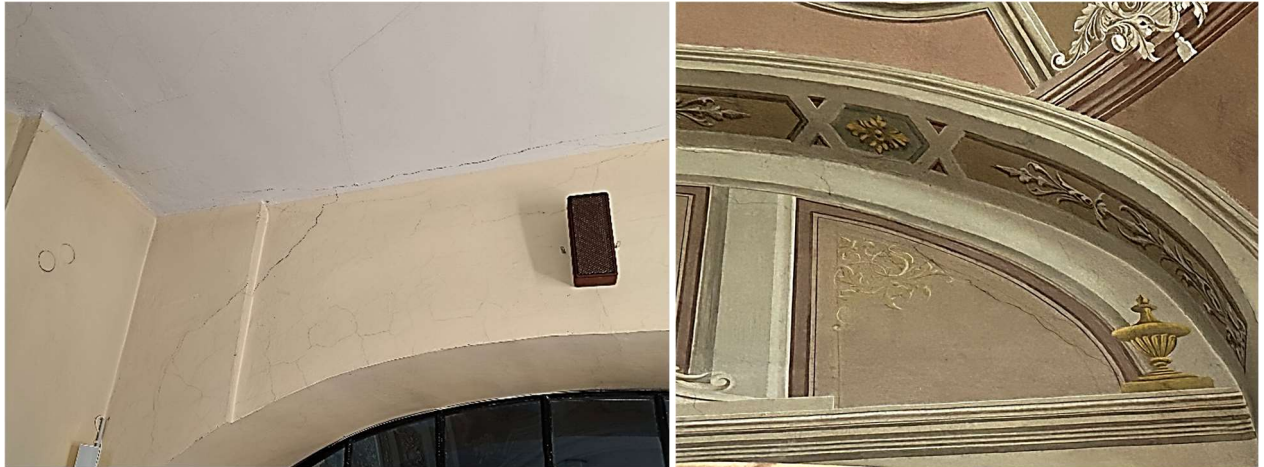
Oštećenje 11 – Pukotina po zidu koji se nalazi između sakristije i svetišta (pogled iz sakristije i pogled iz svetišta)
