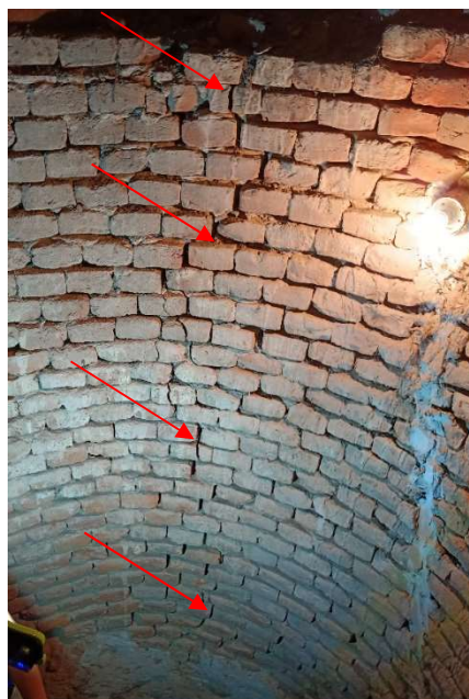
Oštećenje 14 – vertikalna pukotina po zidu stubišta
