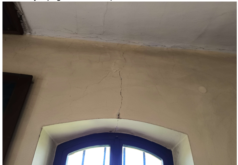
Oštećenje 13 – pukotina u nadvoju Sjeveroistočnog prozora sakristije
