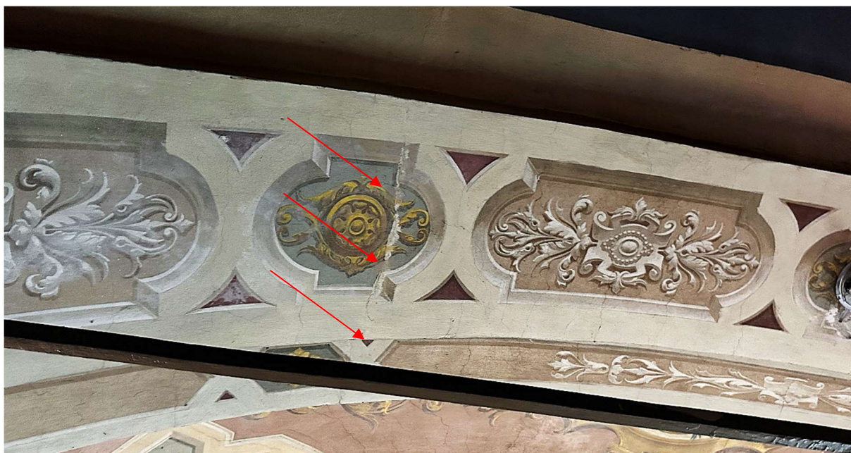
Oštećenje 4 – pukotine na pojasnom luku lađe crkve
