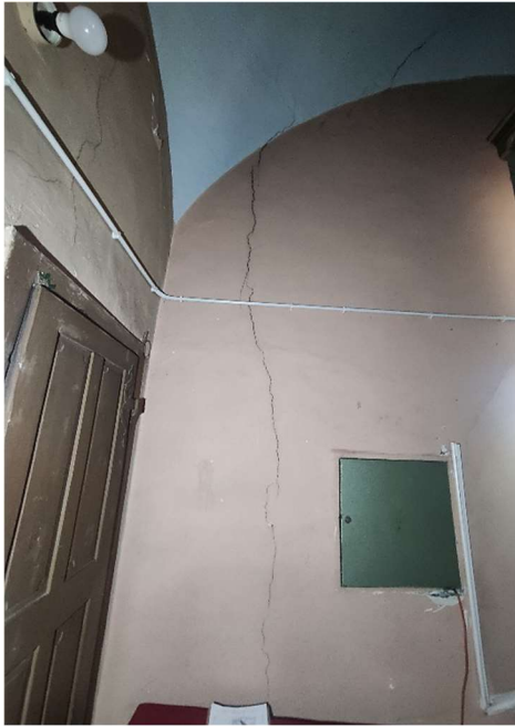
Oštećenje 1 – vertikalna pukotina na jugoistočnom zidu pjevališta
