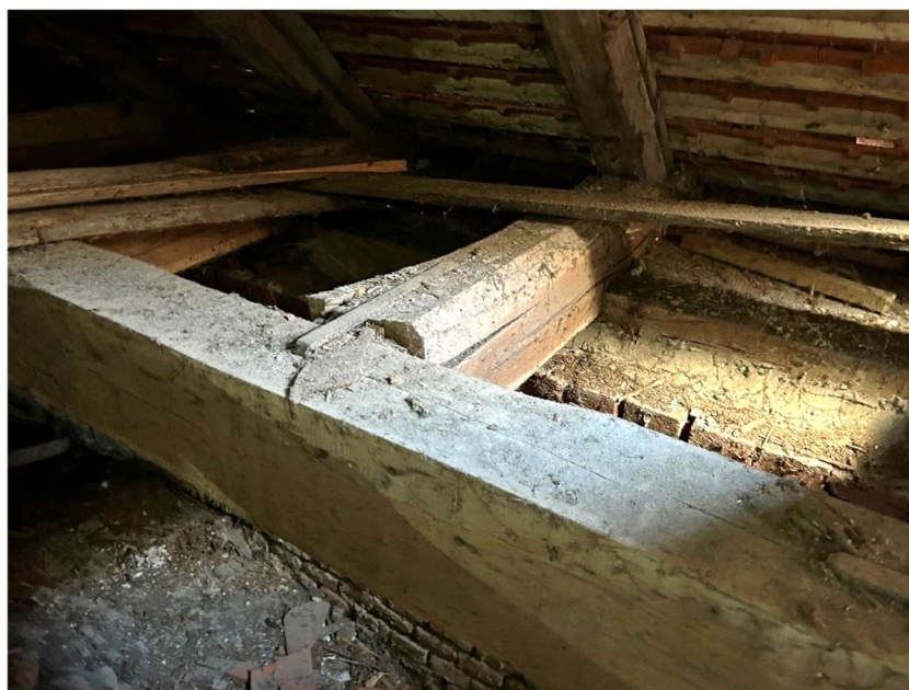
Vidljivo oštećenje i rotacija kusca
